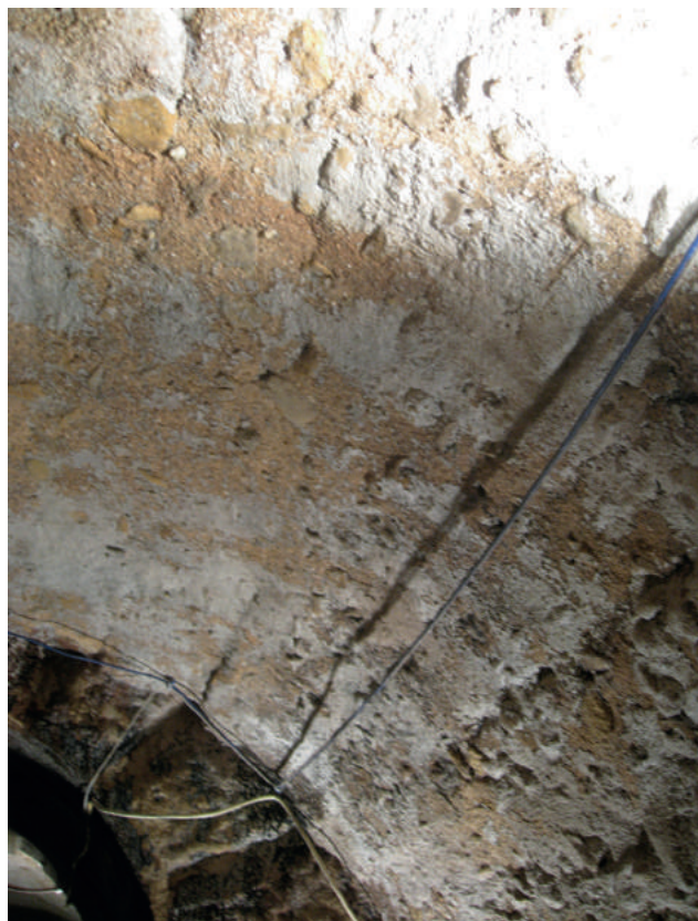
FIG. 17 “Galeria das nascentes”. Pormenor da abóbada realizada com cofragem notando-se os negativos das tábuas do cimbra (© Lídia Fernandes – Museu de Lisboa – Teatro Romano / EGEAC).
